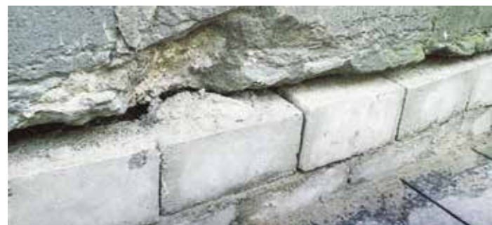
Итог уничтожения гидроизоляции.
