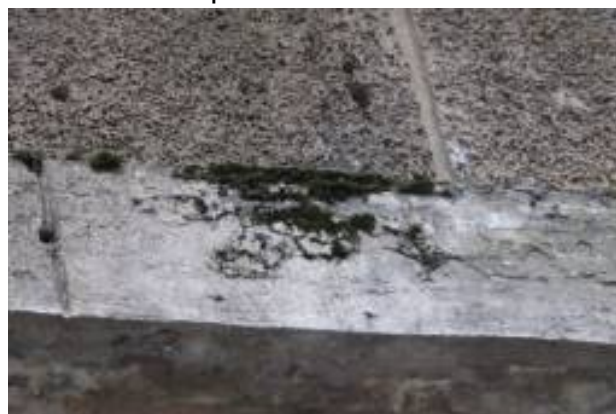
Трещины различной протяженности, направленности и степени раскрытия. Развитие мхов и сине-зеленых водорослей в трещинах
