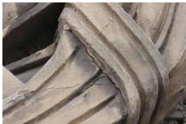
Множественные трещины различной протяженности, направленности и степени раскрытия
