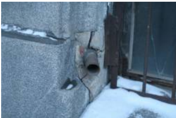
Дефекты механического происхождения
