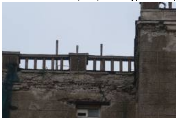
Участки осыпей всех штукатурных слоев до кирпичной кладки
