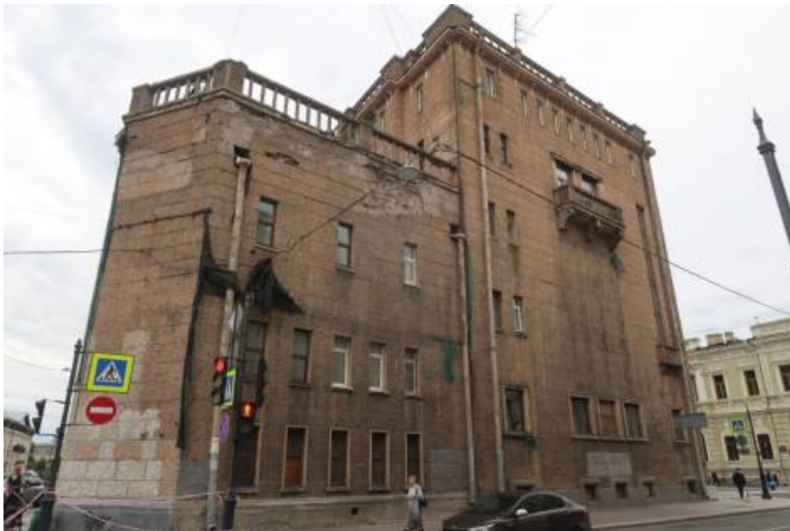
Значительный общий износ отделки
