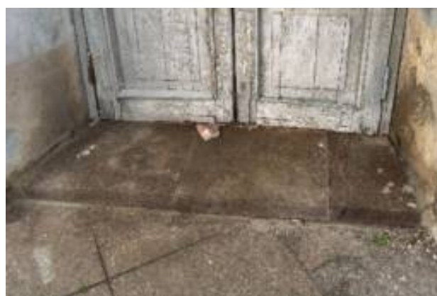
Потеки и капли краски, растворных материалов на поверхности
