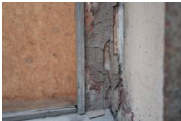
Переувлажнение древесины, определяются участки поражения древесины гнилью
