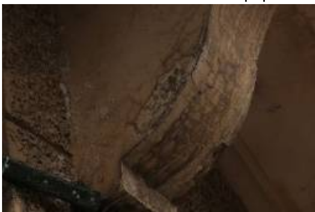
Участки фрагментирования, увлажнение штукатурного слоя в трещинах
