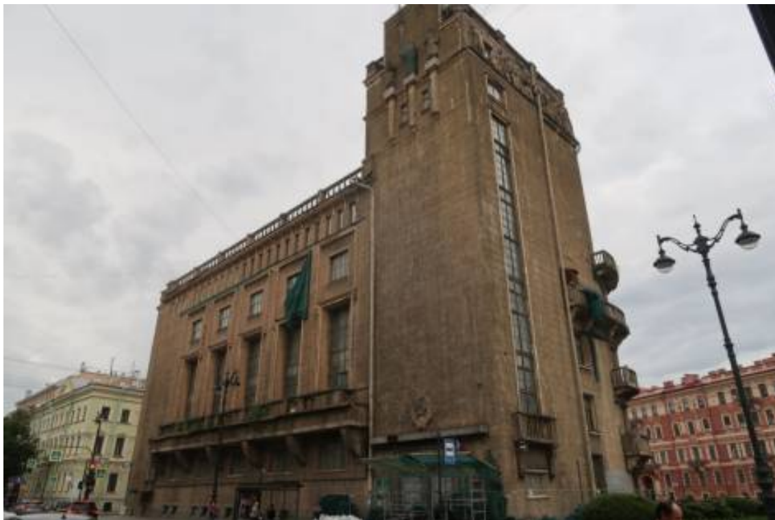
Расслаивание и осыпание слоев штукатурки из-за нарушения конструктивной защиты здания от воздействия атмосферной влаги
