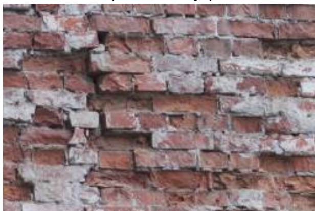
В ряде мест разрушение кирпича в виде пластин и грануляция с образованием отдельных фрагментов, рассечённых сеткой трещин
