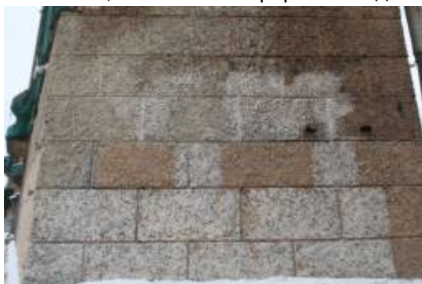
Следы многократных ремонтных перекрасок разными колерами (под слоями краски определяются граффити)
