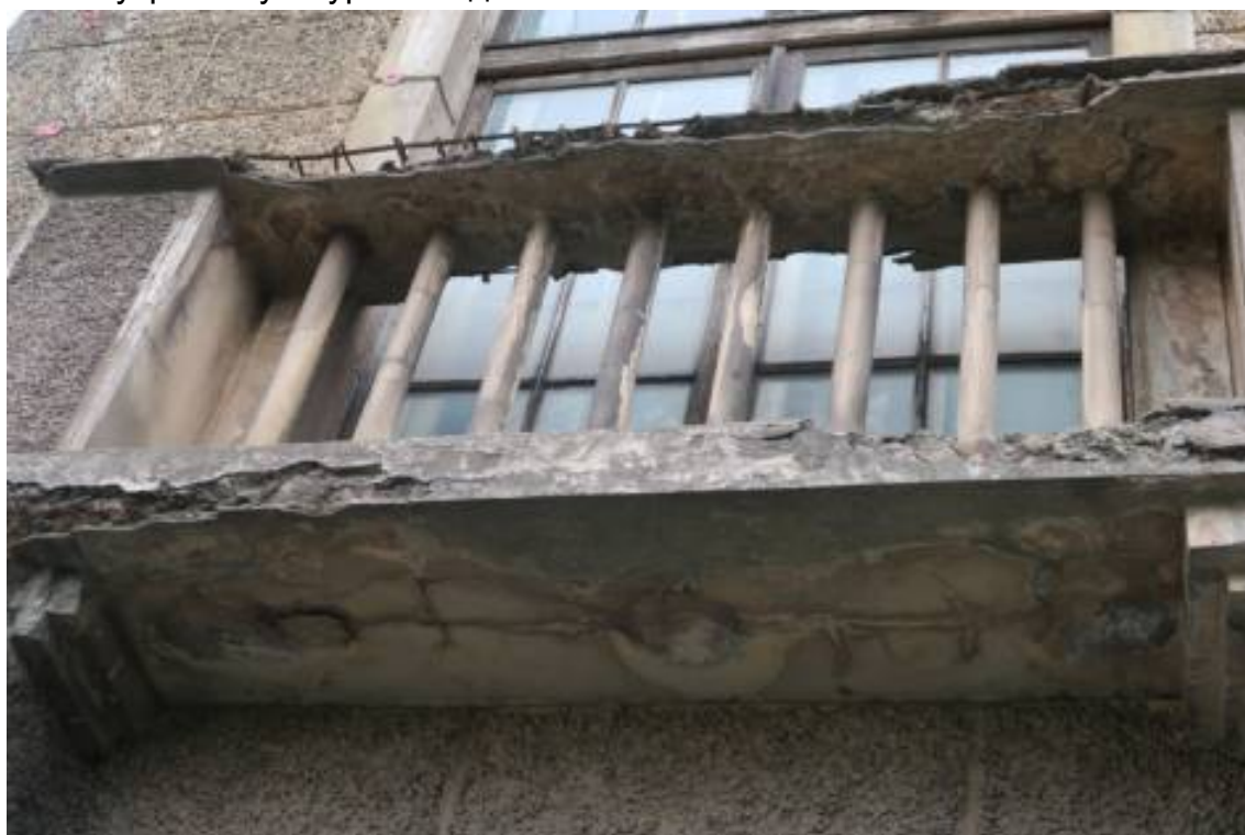
Из-за нарушения конструктивной защиты поверхности фасадов от воздействия атмосферной влаги наблюдается поверхностная и глубокая деструкция штукатурных растворов
