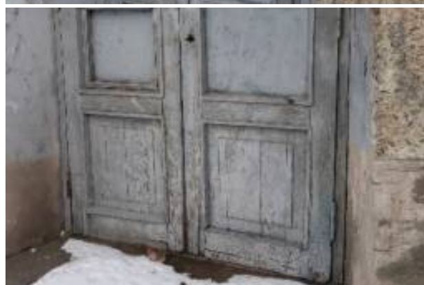
Трещины и щели на участках клеевых сопряжений из-за деструкции и разрушения клея, рассыхание древесины
