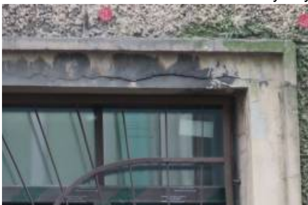
Плотные саже-пылевые загрязнения поверхности
