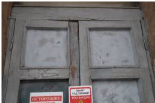
Разрушение красочных покрытий
