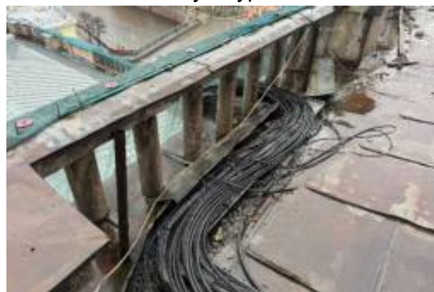
Дефекты механического происхождения, вмятины отверстия, возникшие в ходе монтажа инженерных сетей
