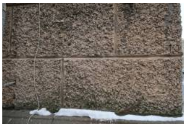
Биопоражение штукатурного слоя в местах постоянного намокания
