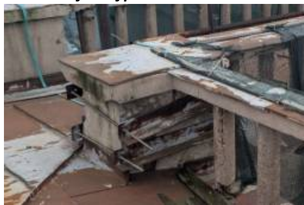
Участки укрепления для исключения обрушения элементов
