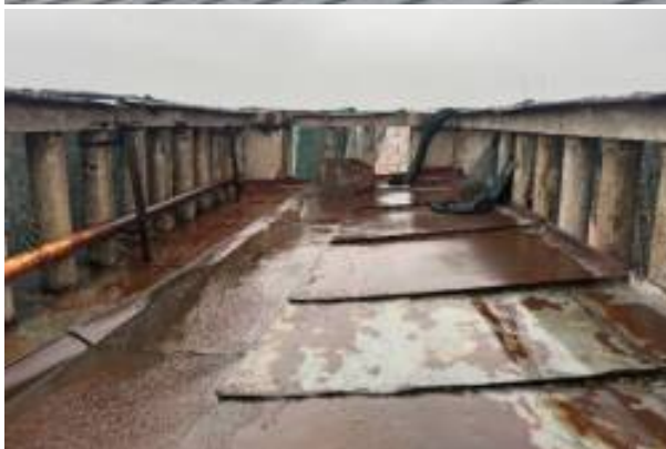
Разрушение оцинкованного покрытия, очаговая поверхностная коррозия металла. Потечи продуктов коррозии
