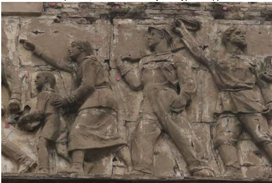
Трещины различной протяженности, направленности и степени раскрытия. Участки скрытого отслоения фрагментов декора от основы, трещины по периметру элементов
