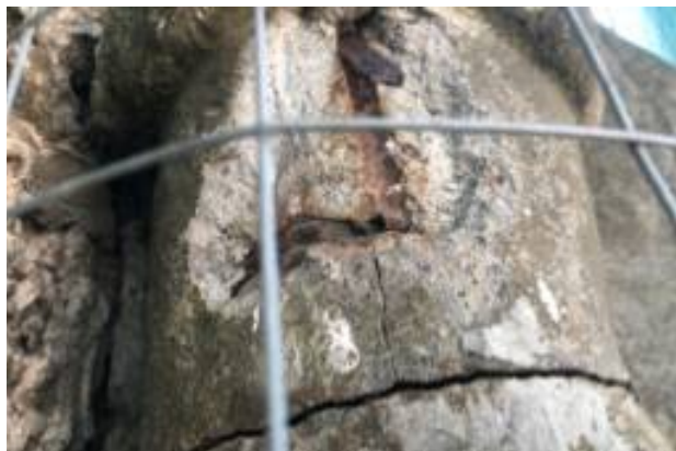
Участки расслоения, фрагментирования, деструкции бетона
