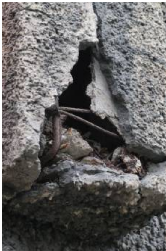
Глубокая деструкция , оголение корродированных элементов
