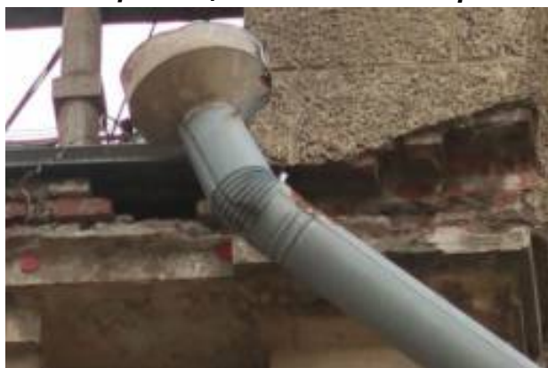
Наблюдаются вывалы отдельных кирпичей
