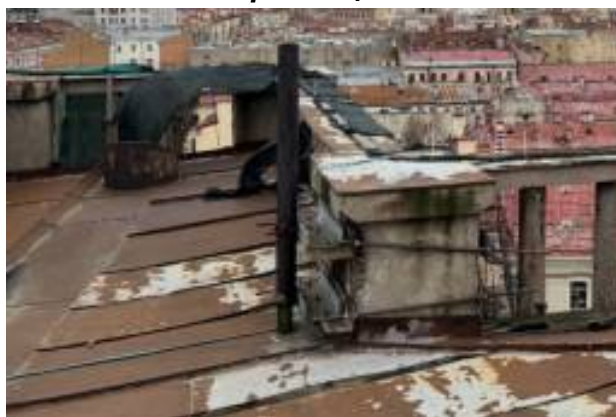
Биопоражение штукатурного слоя в местах намокания
