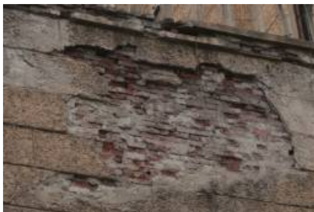
Обширные утраты штукатурной отделки
