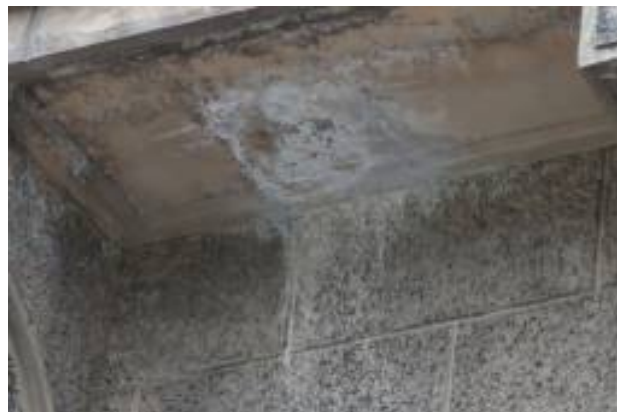
Высолы на штукатурной поверхности, натечные образования
