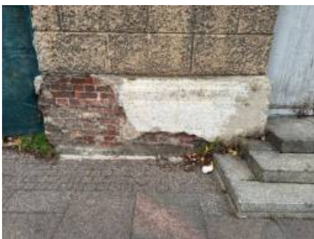
Осыпи штукатурной отделки до кирпичной кладки, глубокая деструкция
