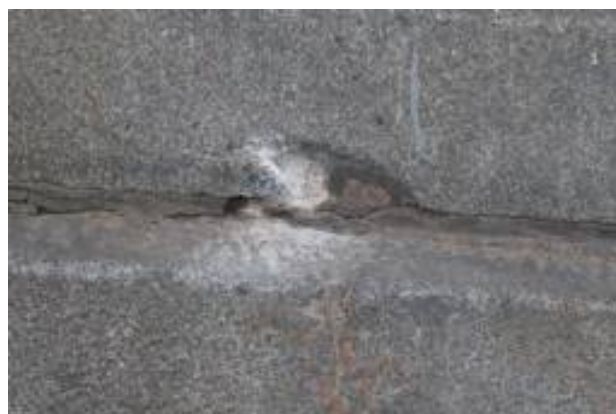
Высолы на поверхности камня
