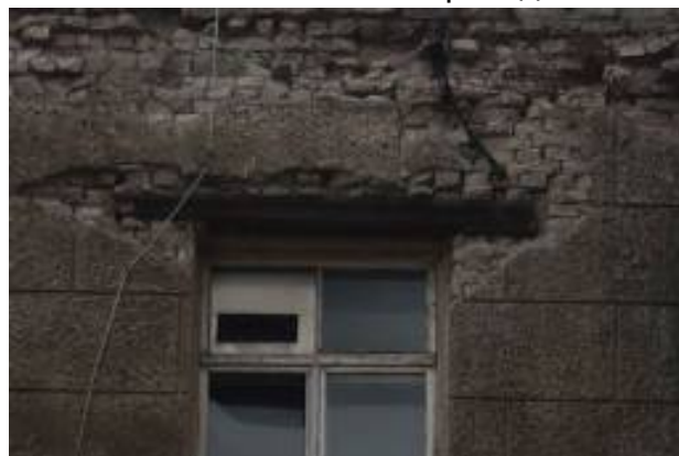
Металлические конструкции корродированы
