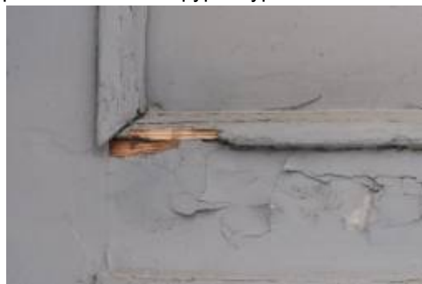
Дефекты в виде сколов, вырывов в массиве древесины
