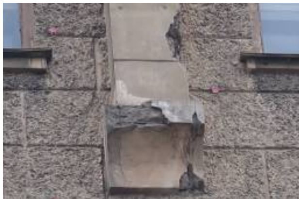
Дефекты в виде сколов, крупных и мелких утрат штукатурной отделки
