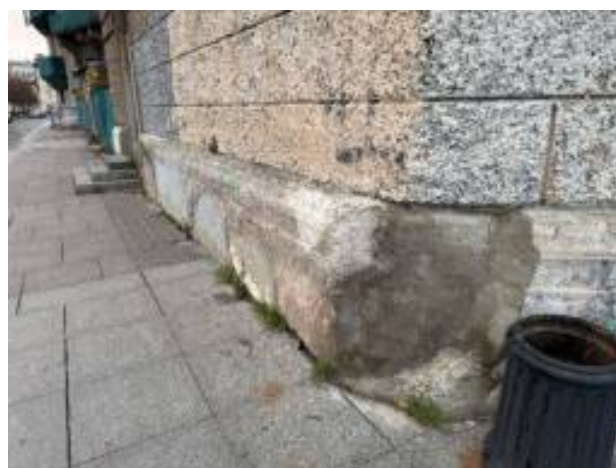
Обширные утраты профиля, обмазки составами на основе цемента
