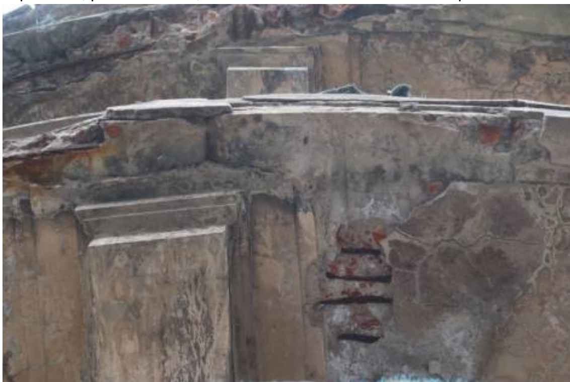
Расслаивание и осыпание слоев штукатурки из-за воздействия атмосферной влаги
