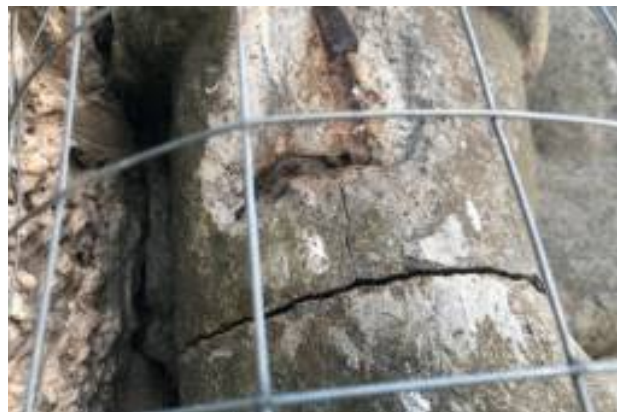
Трещины, в том числе сквозные, опоясывающие
