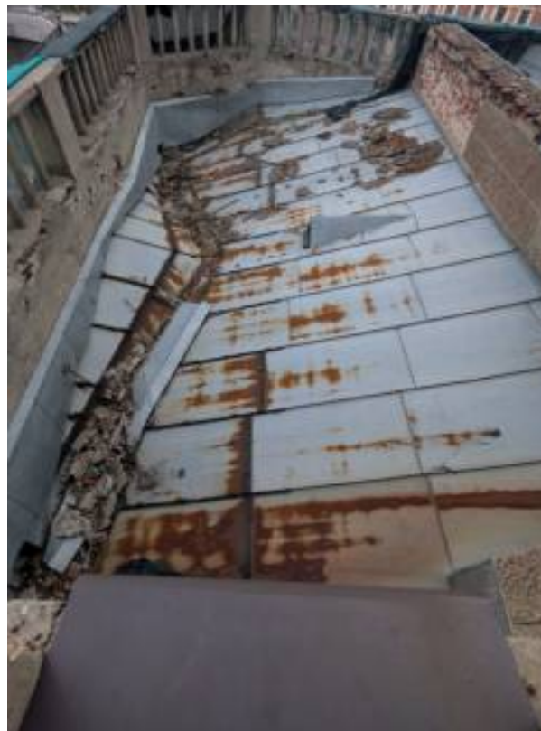
Следы ремонтов: герметизацией швов рубероидом в местах сквозных отверстий и расхождения листов покрытия. Скопление обрушившейся штукатурки
