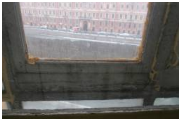
Поверхностные и сквозные трещины в массиве древесины
