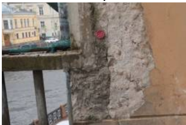
Вспучивание и утраты лицевого слоя отделки
