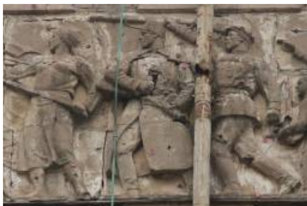
Высолы на поверхности декора, глубокая деструкция, разуплотнения растворных материалов
