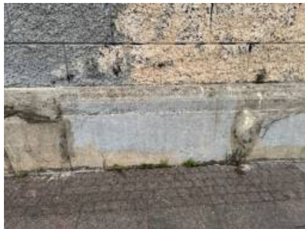
Обширные участки окрасок поверхности
