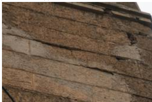
Разуплотнение и морозное разрушение поверхностных слоев фактурной штукатурной отделки в результате воздействия влаги. Наличие отслоений
