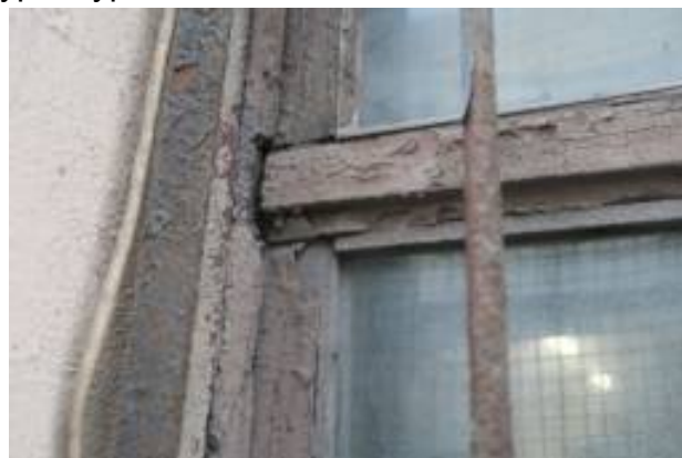
Разрушение и утраты красочных покрытий (трещины в красочных слоях, шелушение, кракелюр с поднятием краев)
