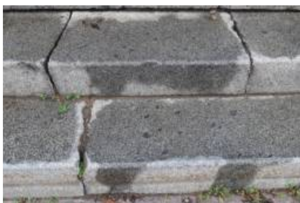
Дефекты в виде сколов камня, сквозных трещин ступени
