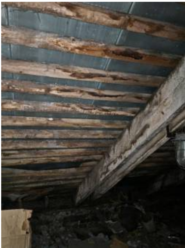
Деструкция древесины за счет биопоражений, разуплотнение древесины под воздействием атмосферной влаги
