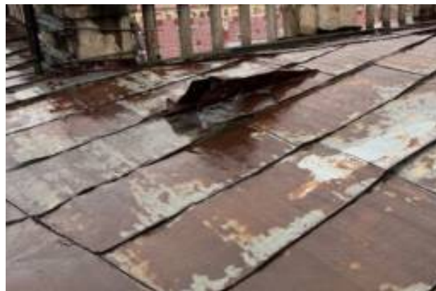
Деформация окрытий световых люков
