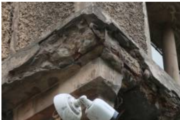
Деструкция отделки и основания в виде выветривания, расслаивания, осыпания
