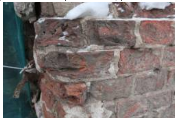
Расслоение кирпича, дефекты в виде сколов, выбоин, трещин
