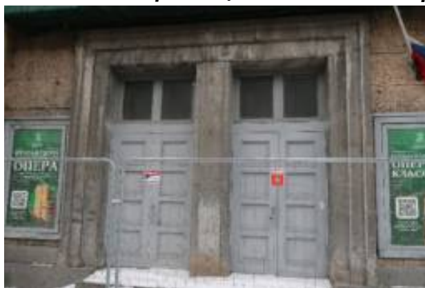
Участки потемнения лицевого слоя отделки из-за переувлажнения
