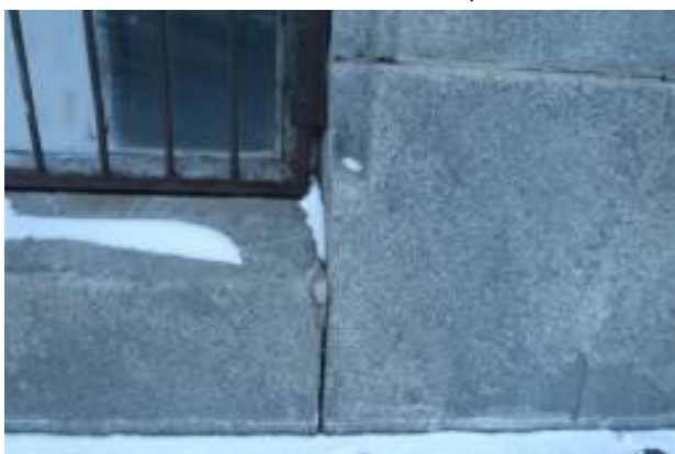
Деструкция и утраты шовного заполнения
