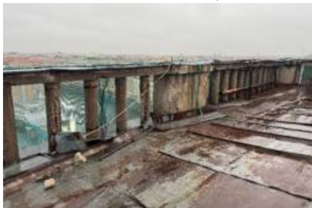
Локально дефекты фальцевых соединений
