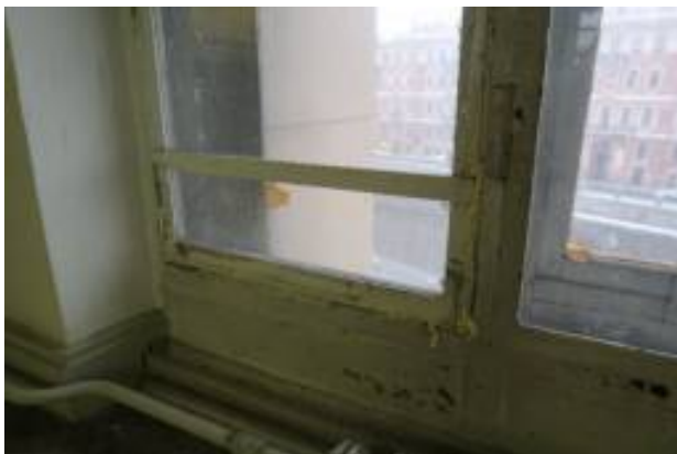
Разрушение и утраты красочных покрытий
