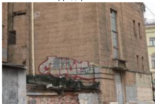
Следы перекрасок поверхности составами разных колеров. Загрязнения антропогенного характера (граффити)
