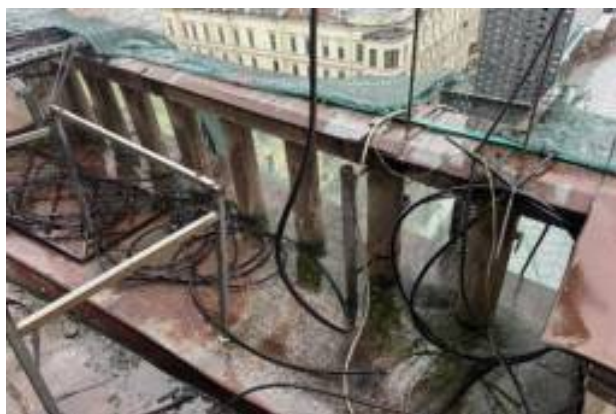
Биопоражение: развитие мхов, сине-зеленых водорослей
