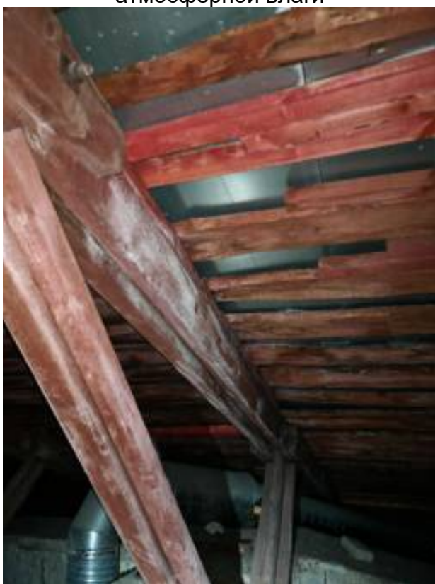
Переувлажнение древесины, определяются участки поражения древесины гнилью
