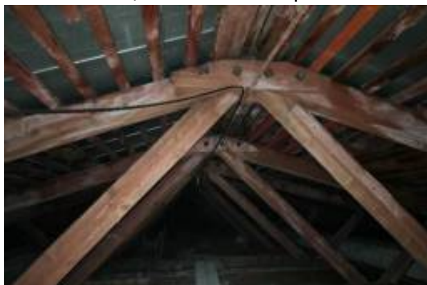
Следы ремонтов стропильной системы
