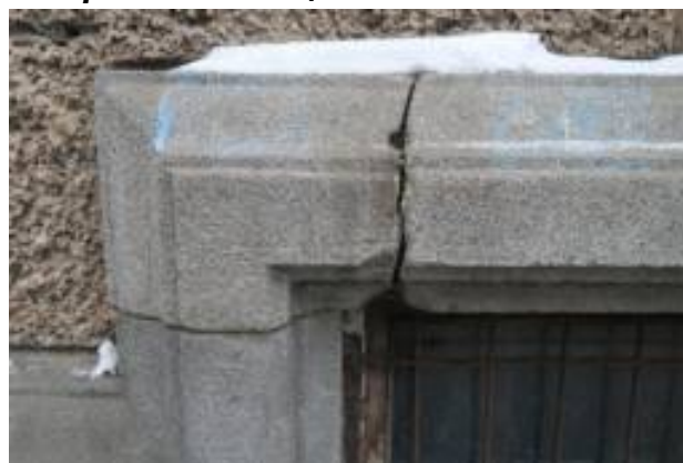
Трещины различной протяженности, направленности и степени раскрытия
