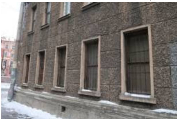
Общий износ конструкций. Трещины и щели на участках клеевых сопряжений из-за деструкции и разрушения клея, рассыхание древесины
