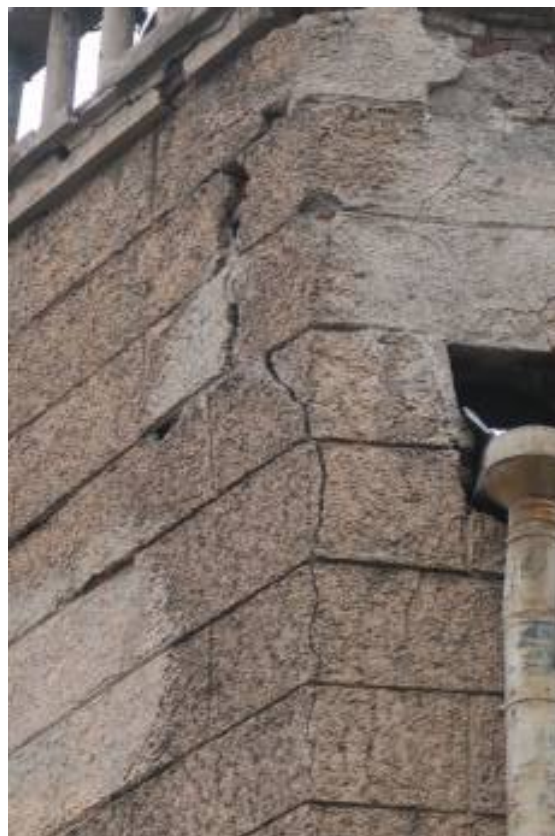
Следы грубых ремонтов, цементные обмазки поверхности
