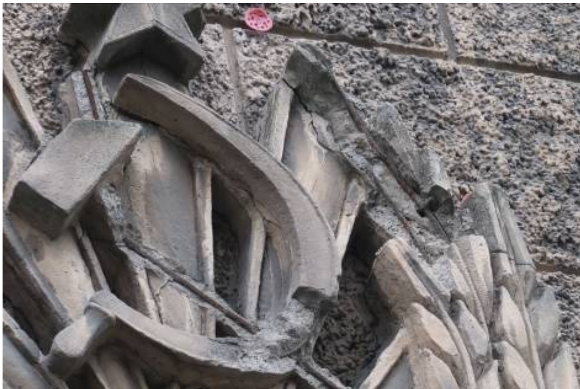
Глубокая деструкция материала, выветривание поверхности и осыпание мелких и крупных фрагментов
