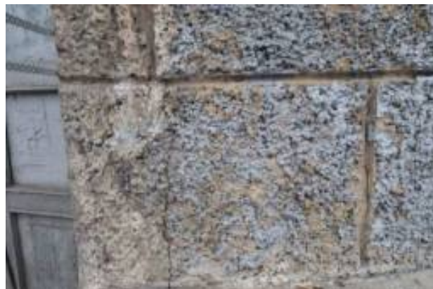
Деструкция многослойной ремонтной окраски штукатурных поверхностей
