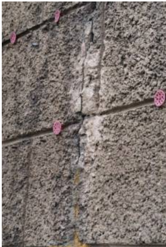
Поверхностная и глубокая деструкция штукатурных растворов
