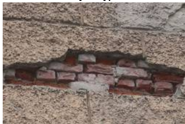
Деструкция и утраты шовного заполнения, кладочного раствора
