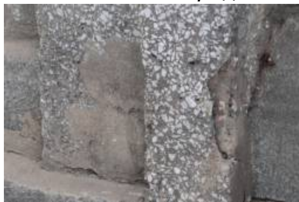
Дефекты в виде сколов, выбоин
