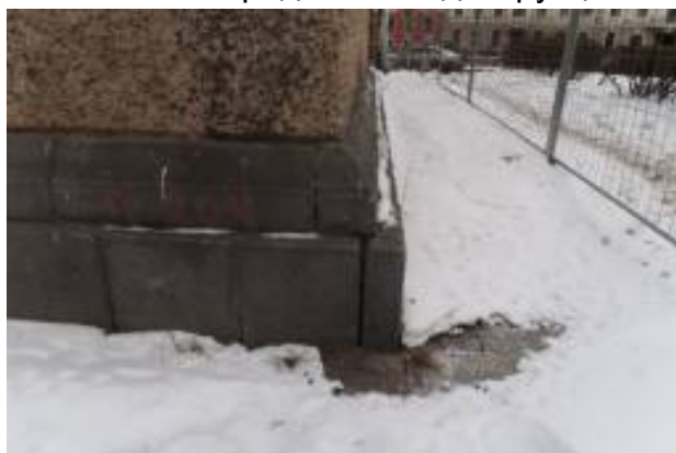
Смещение плит относительно друг друга, нарушение геометрии
