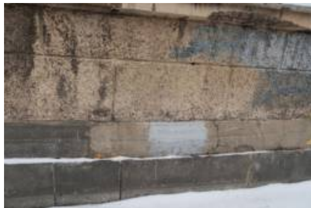
Утрата цельных плит облицовки
