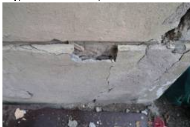
Вспучивание и отслоение штукатурного слоя от основы, зоны бучения
